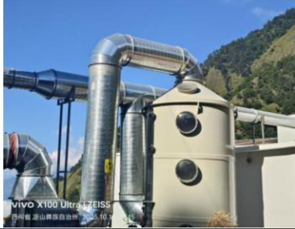
破碎车间配套湿式除尘器
